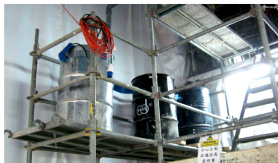
工地中的小型沉澱池設備
